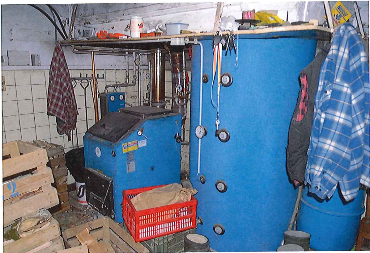
Chaudière à bois dans l'ancienne cuisine au rez-de-chaussée
