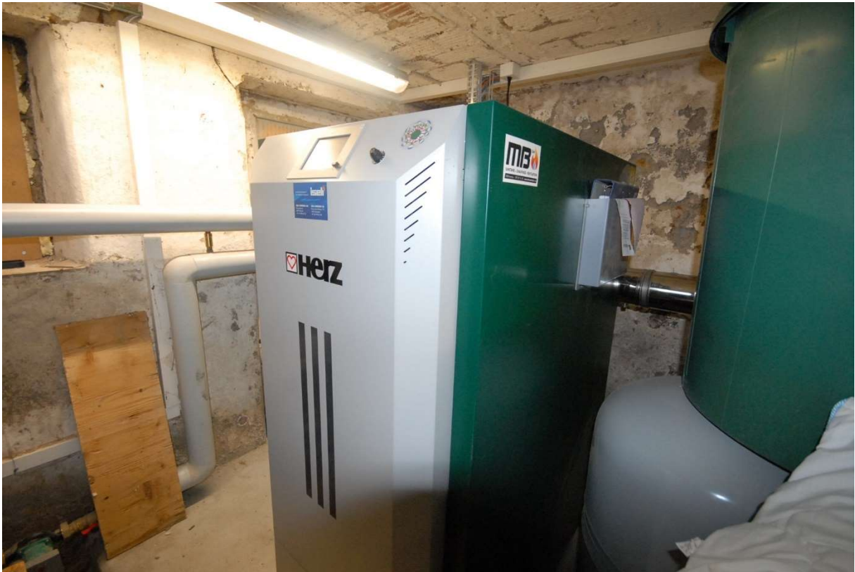
Chauffage à pellets dans le bâtiment de la brasserie, qui alimente également les 4 pavillons
