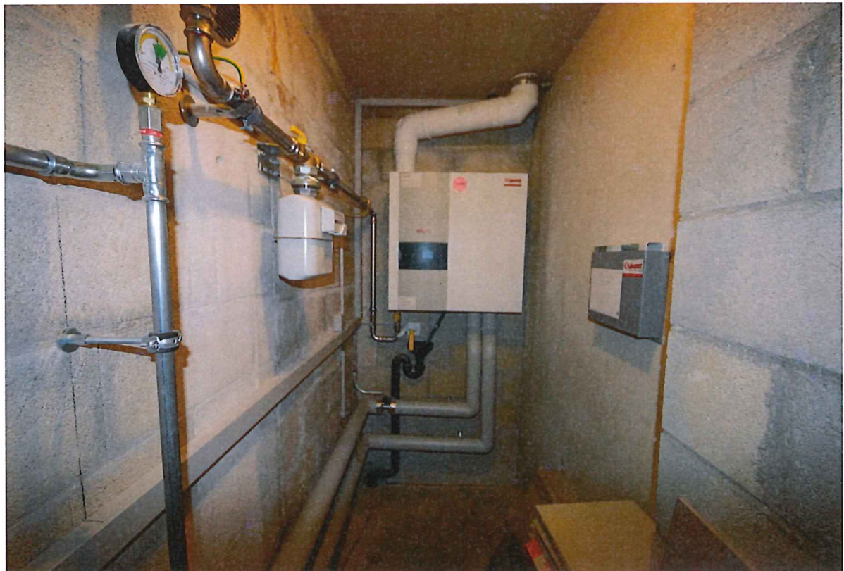
Chaudière à gaz dans local commun au sous-sol
