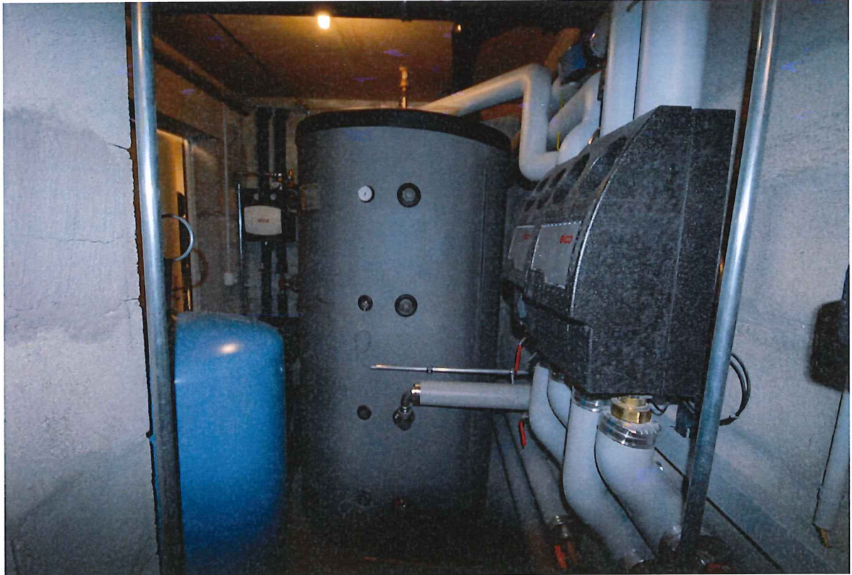
Autre vue sur le local technique commun au sous-sol
